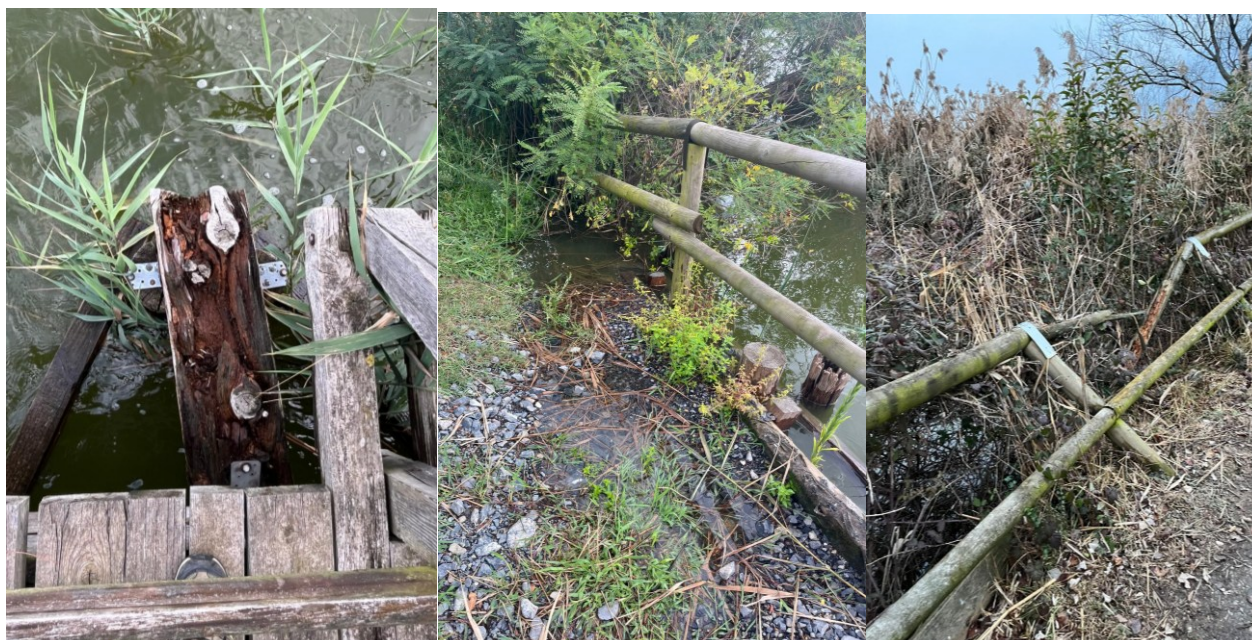
Figura 6 – Dettagli percorso centrale - assi con marcescenze, argini allagati e staccionate crollate
